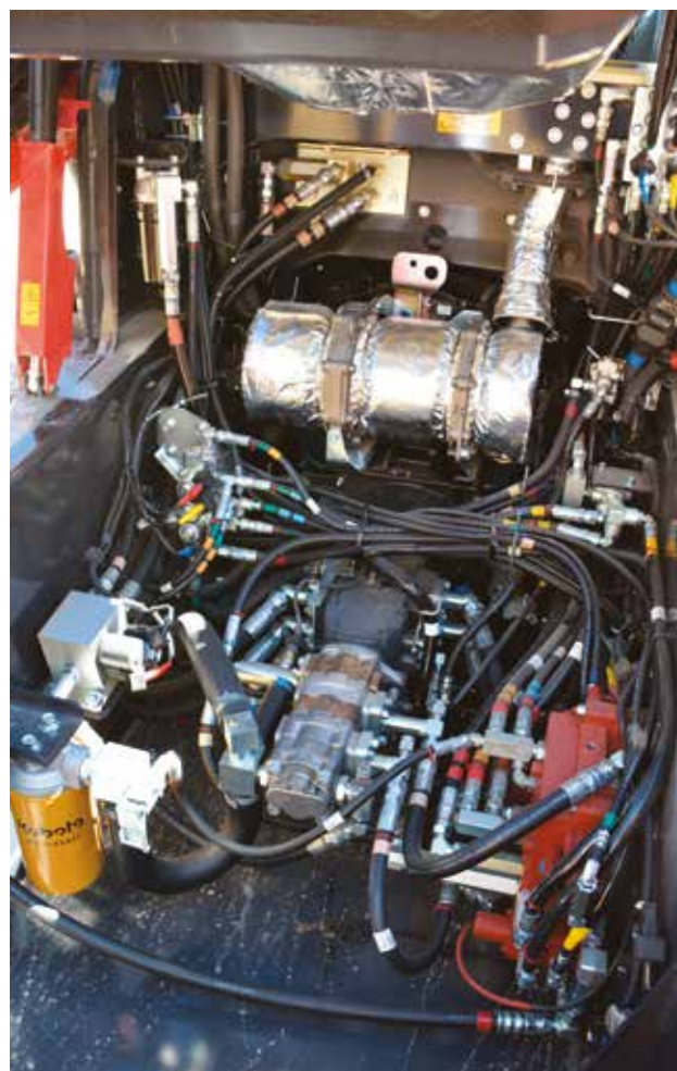
Motore e pompe idrauliche montate in linea
