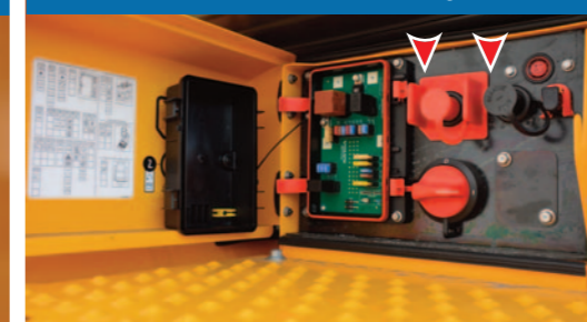
Quadro con avviamento d'emergenza
