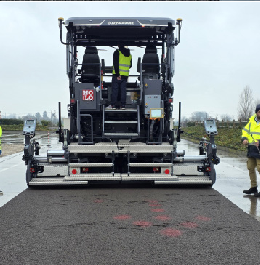
Finitrice Dynapac SD25 equipaggiata con sistema di controllo 3D Topcon RD-MC Max in configurazione integrata: la regolazione automatica di quota e pendenza del banco avviene in tempo reale sulla base del modello digitale condiviso, trasformando la stesa in un processo guidato dal dato e non più dal piano esistente.
