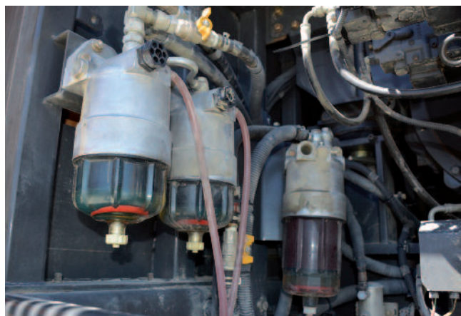
Nuovo microfiltro di sicurezza a valle dei tre elementi con vasca
