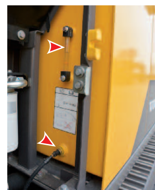
Alla base del serbatoio è presente un sensore della temperatura dell'olio idraulico. Più in alto un indicatore ottico di livello.
