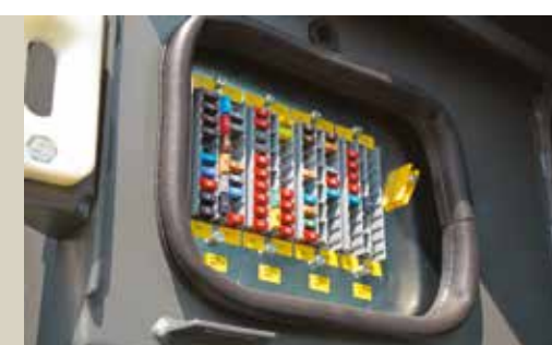
Vano che preserva la pressurizzazione cabina
